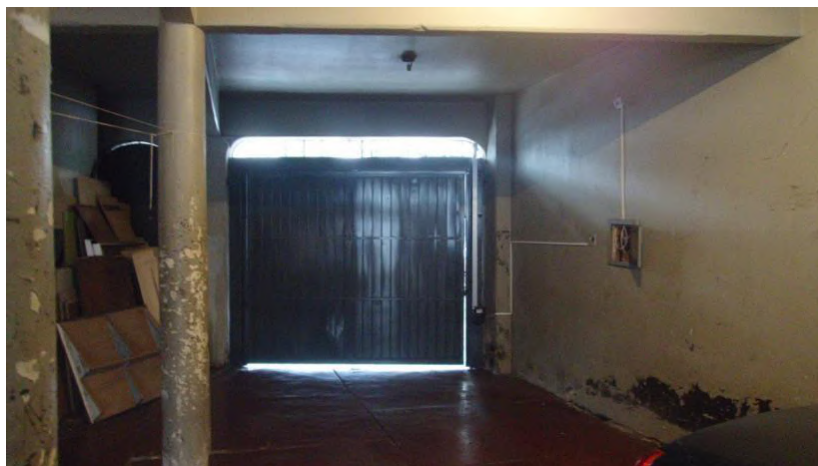
Figura 19: Rachaduras no piso da garagem Fonte: Ary Ney Chaicoski Junior, 2017
