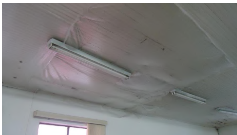
Figura 21: Plástico bolha instalado como paliativo para problemas do forro Fonte: Ary Ney Chaicoski Junior, 2017
