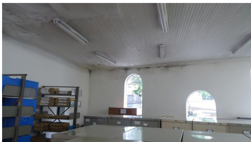
Figura 20: Infiltrações nas paredes e forro do anexo 1 Fonte: Ary Ney Chaicoski Junior, 2017
